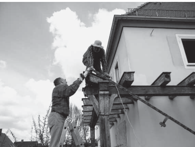
Vorstandsmitglieder legen bei der Gebäudesanierung selber mit Hand an: der Vorsitzende Axel Pfäff-Schneider (links) und sein Stellvertreter Hansmartin Volz (rechts) beim Abbau des maroden Balkons.
